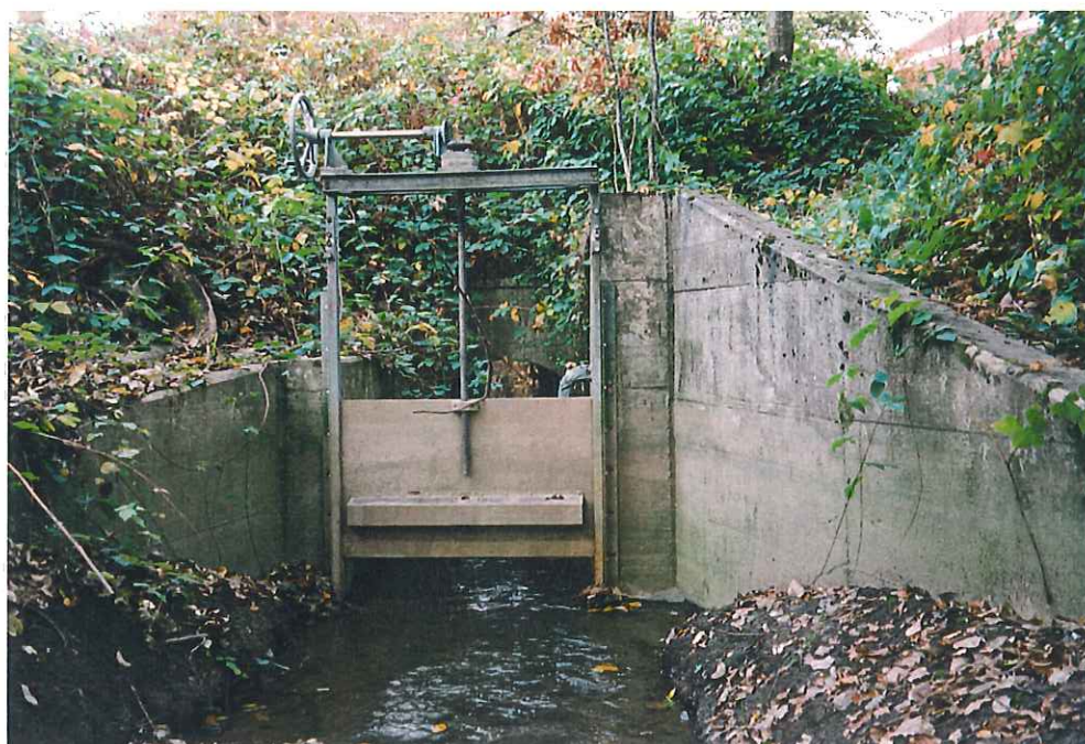
Photos n°7 et 8 : Entonnements et vannes devant les passages sous les routes près d'ABW (7), et sous la route cantonale (8). Ces ouvrages servent de barrage en cas de pollution (hydrocarbures).
